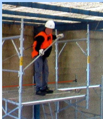
L'OPERATORE PUO' LAVORARE SUL PIANO SUPERIORE IN SICUREZZA
