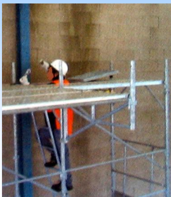
EFFETTUARE IL SECONDO ANCORAGGIO E TIRANTARE LA LINEA VITA CON IL CRICCHETTO
