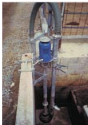
Aeratore di profondità
