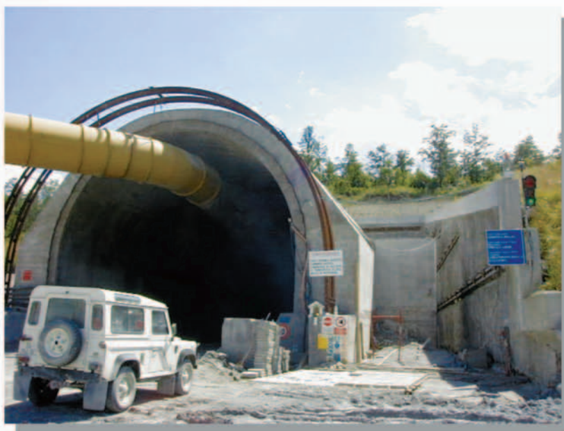
Tubo di ventilazione
