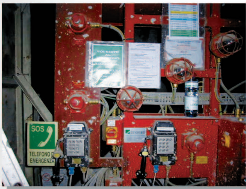
Centralina di monitoraggio
