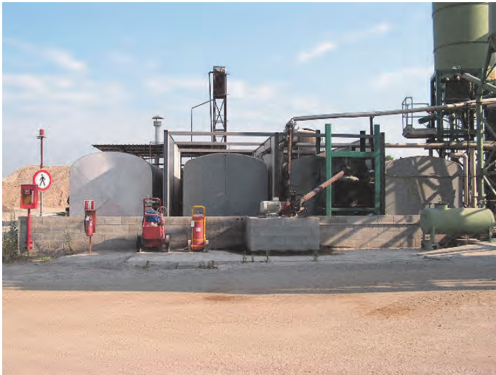
Figura 16 - Stoccaggio bitume nello stabilimento di produzione
