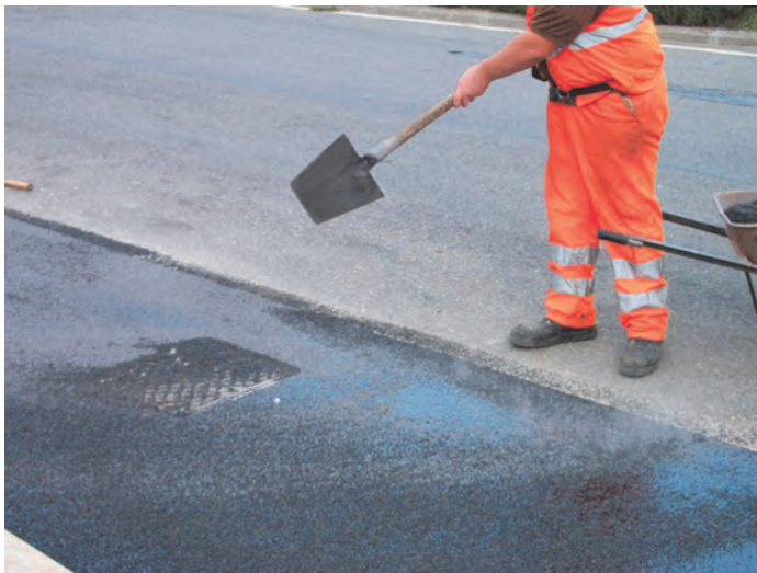
Figura 35 - Spargimento di sabbia su marciapiede
