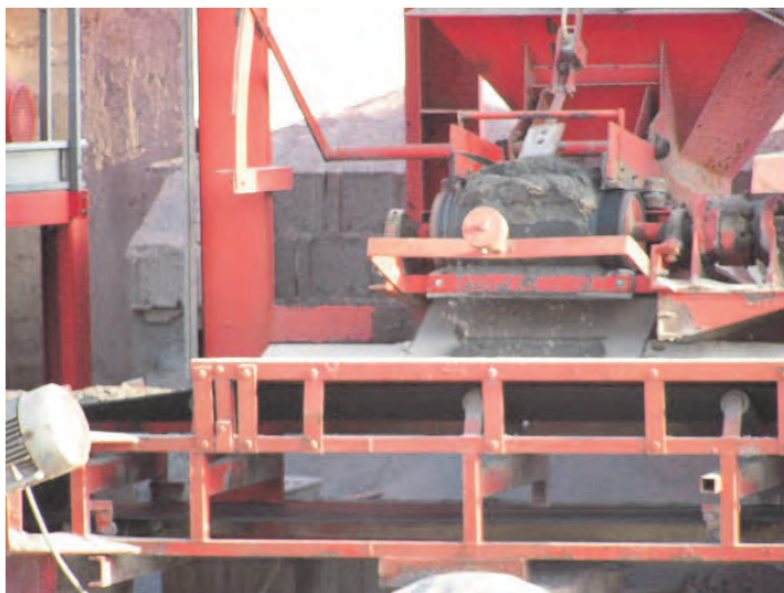
Figura 18 - Tramogge di predosatura ponderale: particolare
