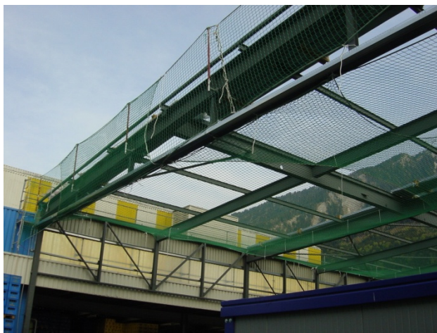
4 In questo edificio industriale la rete di sicurezza funge da protezione lungo il perimetro del tetto.
