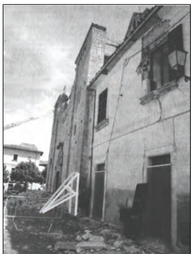
Puntellamento in corrispondenza del rigonfiamento della lesena lato destro (Archivio NCP).
