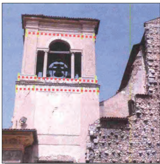
Messa in sicurezza del campanile con tiranti o fasce in poliestere con eventuale sbadacchiatura degli archi (Archivio NCP).
