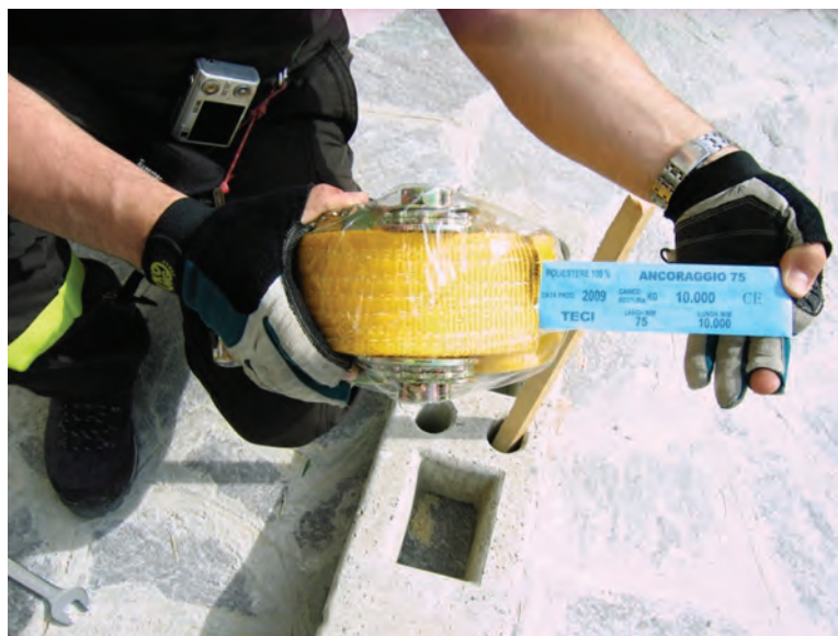
Fasce in poliestere impiegate per la tirantatura.
