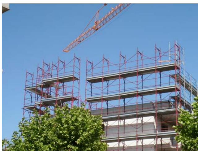
Figura 13– Ponteggio privo di ancoraggio
