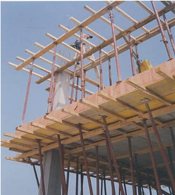
Fig. 4 Assenza di protezioni contro la caduta
