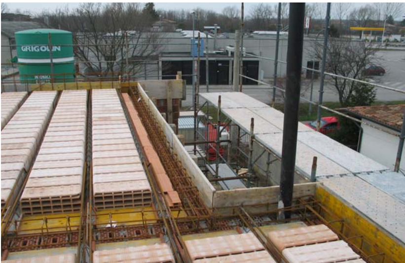
Figura 6- rientranza edificio priva di ponteggio
