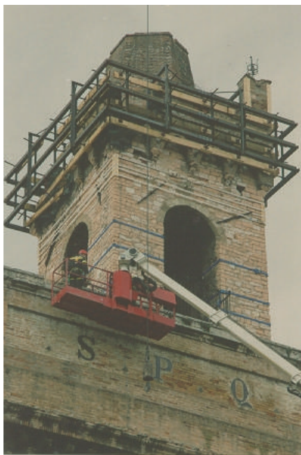
Figura 2.3 Intervento provvisorio delle squadre VVF SAF alla torre civica di Foligno (PG) in occasione del terremoto del 26 settembre 1997.
